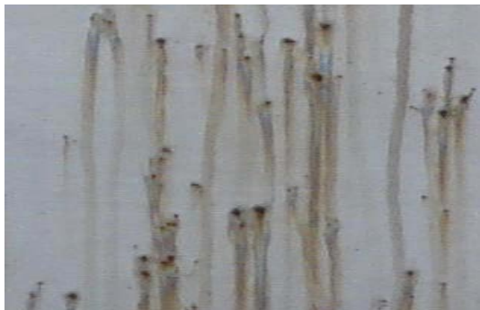
傳統的防鏽塗料孔蝕由金屬內部生長
