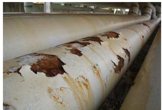
傳統的防鏽塗料鏽蝕由刮傷或裂縫處往周邊擴散蔓延，導致塗層剝離。
